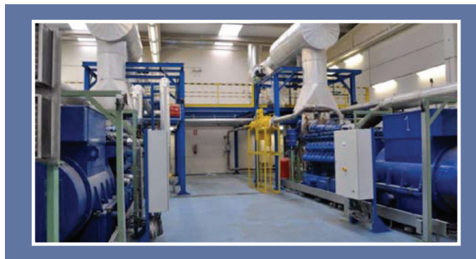
Figura 5.1. Generación de energía eléctrica a partir de biogás. (Compañía Ain_Tech, España).
