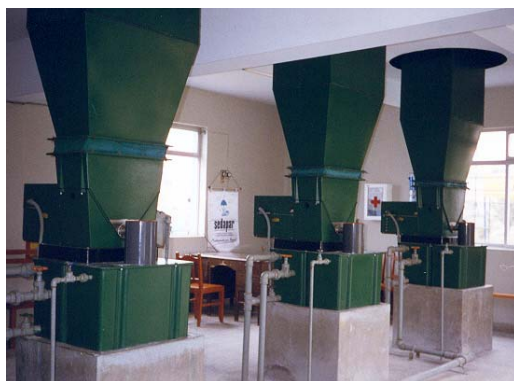
Dosificadores y tanques de disolución
