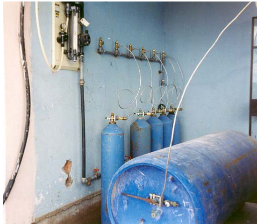
Cilindros múltiples de 75 Kg (“manifold”) y tanque de una tonelada métrica al eyector
