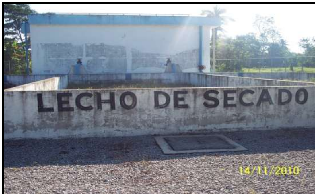
Imagen de lecho de secado de la planta de tratamiento de aguas residuales.
