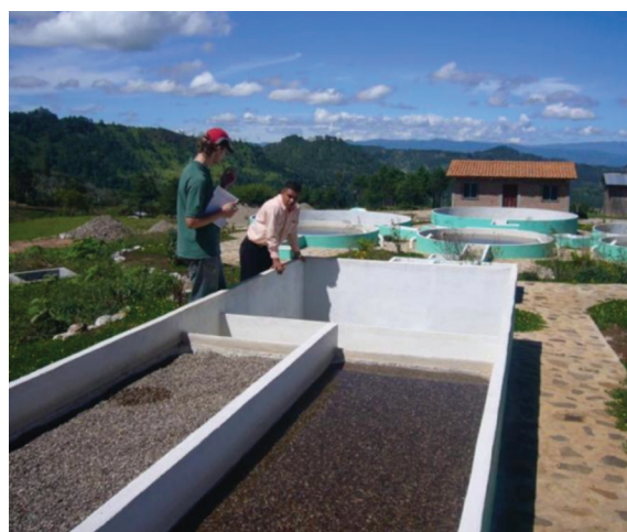
Figura 4-4: Pre-filtro del diseño FGDi de una planta FiME en San Pedro de Tutule, La Paz, Honduras. Caudal máximo de la planta: 8 L/s.
