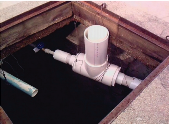
Figura 4-30: Clorador de tabletas hecho de tubos PVC instalado en un tanque de almacenamiento en Honduras (fuente: ADEC).
