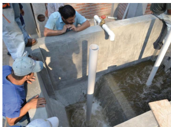
Figura 4-2: Sedimentador directo con tolvas de lavado hidráulico, primer proceso de tratamiento en la planta potabilizadora tipo AguaClara en la municipalidad de Marcala, La Paz, Honduras (fuente: AguaClara, la ONG Hondureña Agua Para el Pueblo, y la ONG Italiana ACRA). En esta foto el sedimentador se está llenando.
