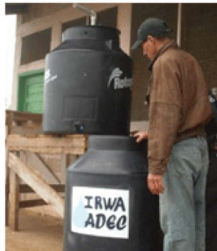
Figura 4-25: Sistema “Depurador” de IRWA y ADEC, Chinacla, La Paz, Honduras. Se realiza un proceso de coagulación, floculación, y sedimentación en el tanque plástico de arriba de forma manual con un procedimiento parecido al de una prueba de jarras. Después de un tiempo de sedimentación, se decanta el agua al tanque plástico de abajo donde se le dosifica cloro.
