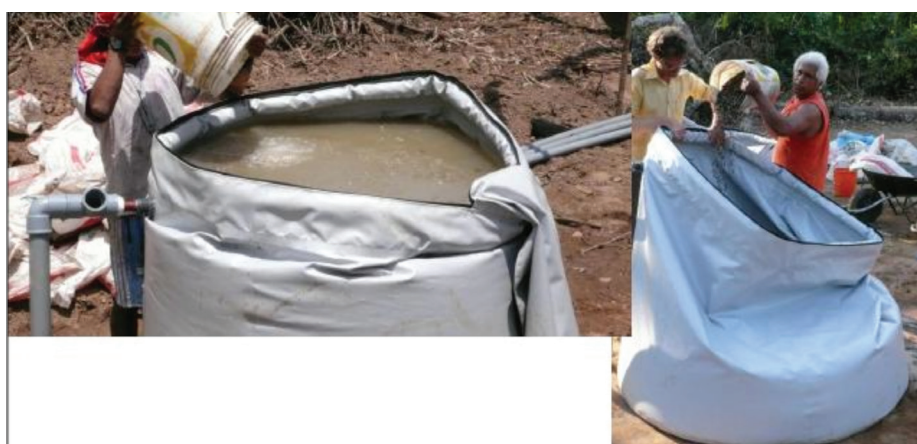
Figura 4-11: Una planta potabilizadora de pre-filtración y FLA en tanques flexibles de geotextil en una comunidad remota en la selva peruana en la zona de Manu. Se utilizó el geotextil por su portabilidad, pero el diseño hidráulico y los medios filtrantes son iguales a los de filtros gruesos y FLA convencionales (Blackburn & Stellema, 2009).
