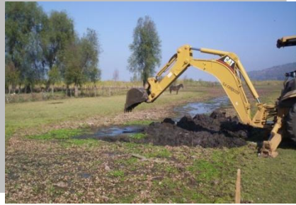
Extracción de fangos
