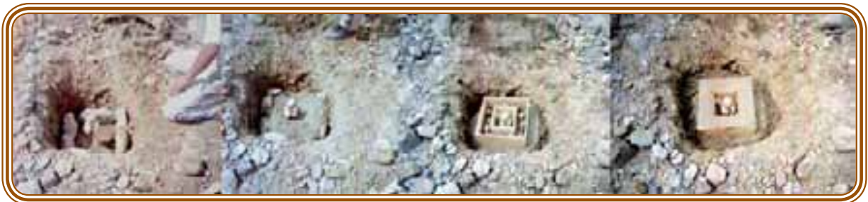
Figura 13 Cámaras de protección de los piezómetros, para mediciones futuras
