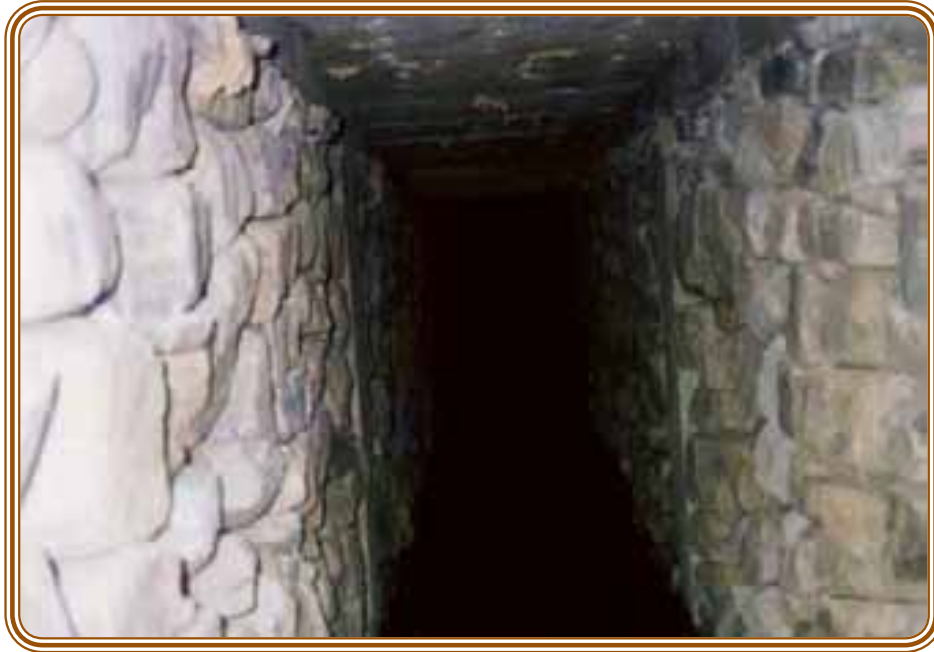
Figura 2.2.5 Galería Tipa Tipa; vista interior, muros de mampostería seca y encadenado de H°A° 2
