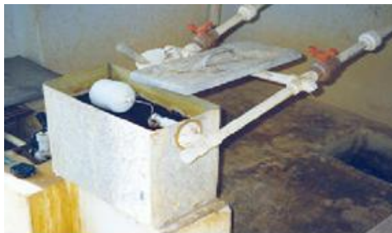
Fig. 5. Tanque con válvula flotador
