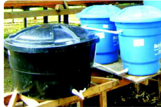
Filtros de arena (azul) y tanque de almacenamiento (negro) de agua tratada instalados en el municipio de El Charco, Nariño.
