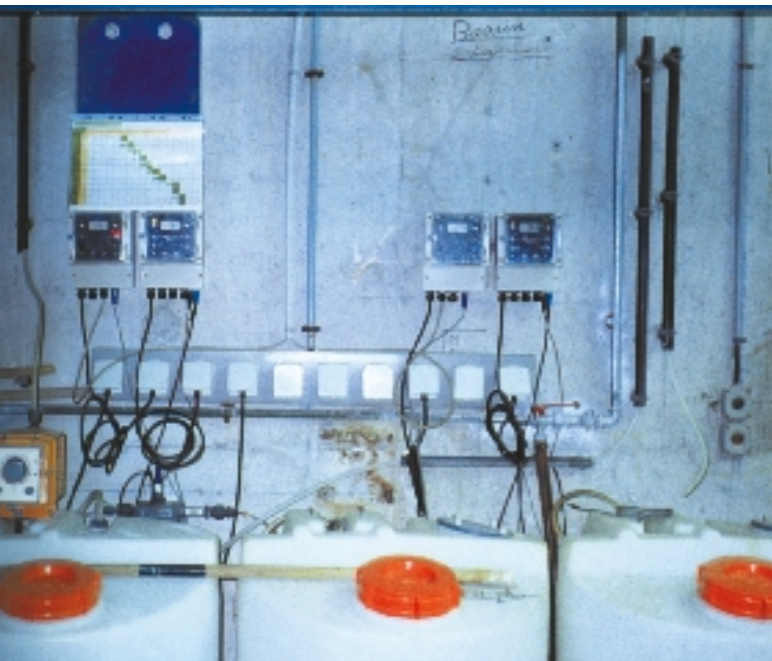
Bomba dosificadora de inyección de solución clorada
