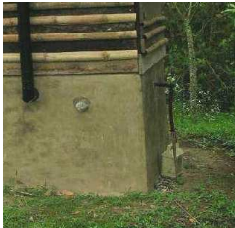
Figura 4.13 Tubería de ventilación.
