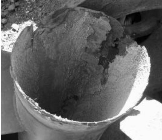
Figura 1. Efectos corrosivos del agua.
