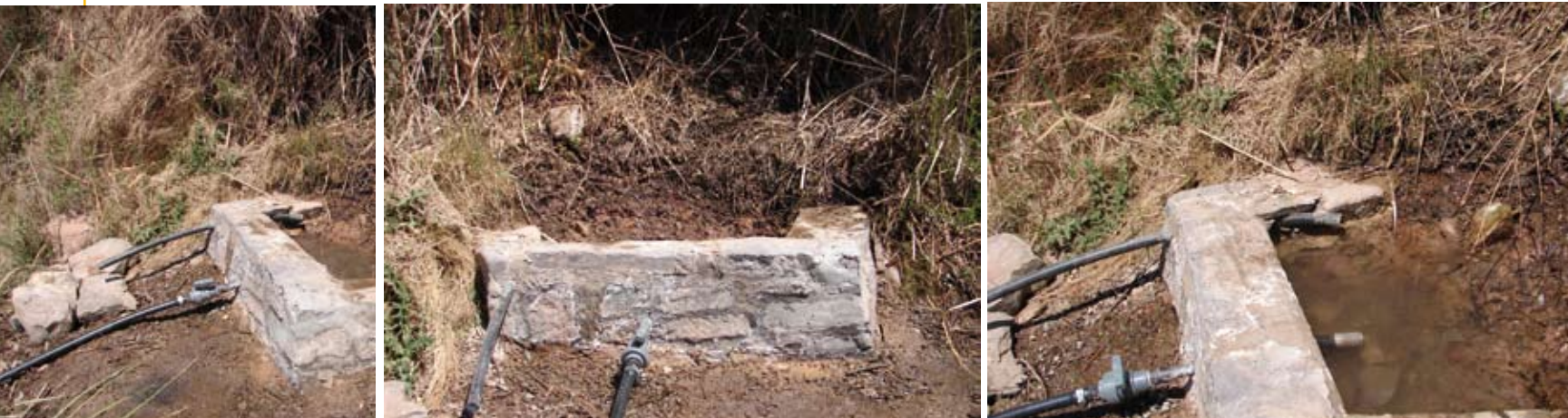
Salida con filtro y tubería de rebalse en manantial de ladera concentrado. Maimará. Jujuy.
