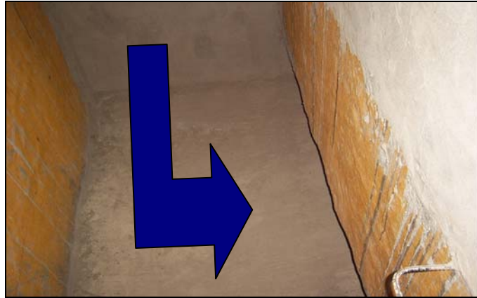
Figura 12. Tanque 15C, de paso, al sedimentador final
