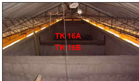
Figura 13. Tanques 16A y 16B, sedimentador final
