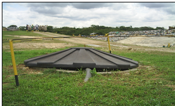
Figura 4. Tanques de recirculación del lixiviado
