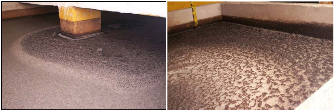
Figura 9. Tanques 14 A Y 14B
