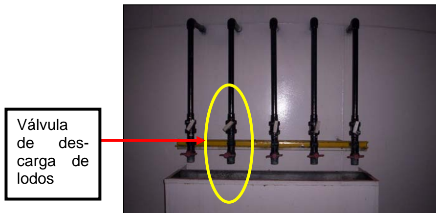
Figura 32. Purga de lodos reactor; Colanta planta UHT.
