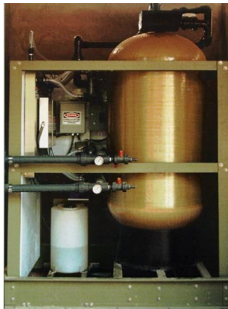
Figura 5.25. Equipo de desinfección con tubos de teflón
