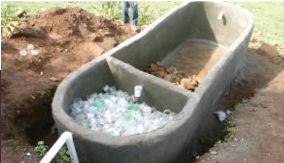
Figura 2.19. Tanque séptico y filtro anaerobio.
