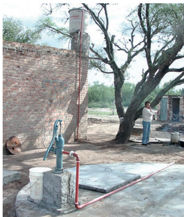
Figura 11. Mecanismo de bombeo manual para extraer y elevar agua con una bomba de hierro fundido
