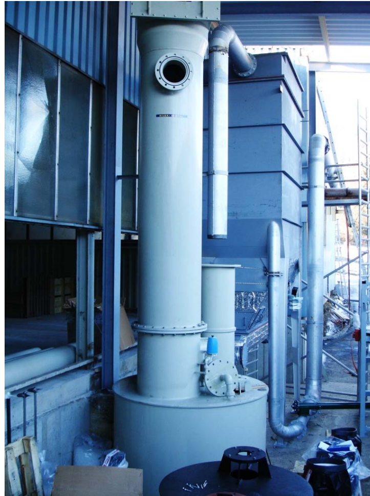
Abgasreinigung, Filter und Wäscher
