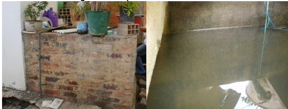
Figura 14 Tanque de almacenamiento 2
