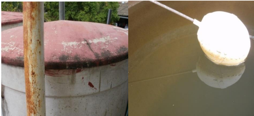
Figura 16 Tanque de almacenamiento 4
